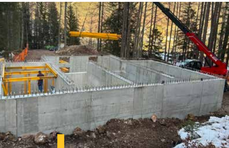
SERBATOIO DI ACCUMULO CADIN - CORTINA
